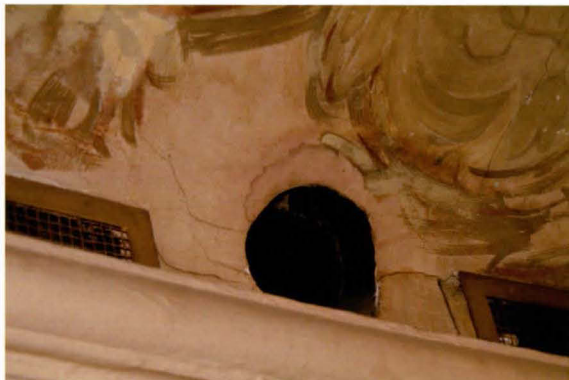
Kolmannen parven kattoa kiertävän listan päälle on sijoitettu 1930-luvun teatteritekniikkaa: tuloilmasäleiköt ja värivalot.
