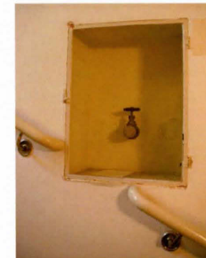
Alkuperäinen paloposti 2. kerroksessa
