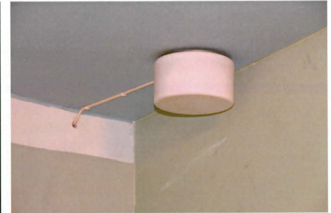
Tyypillinen 1930-luvun opaalilasinen, siro ja pienellä kattokiinnityslautasella varustettu käytävävalaisin taustakäytävän katossa.
