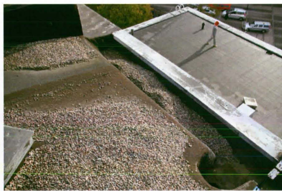
Yläosan bitumikatteen päällä on singeli, alaosan uudemman sirotehuovan ei. 11/ 2007
