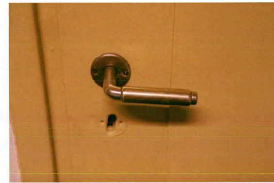
4. kerroksen 1930-l peltisen palo-oven painike.
