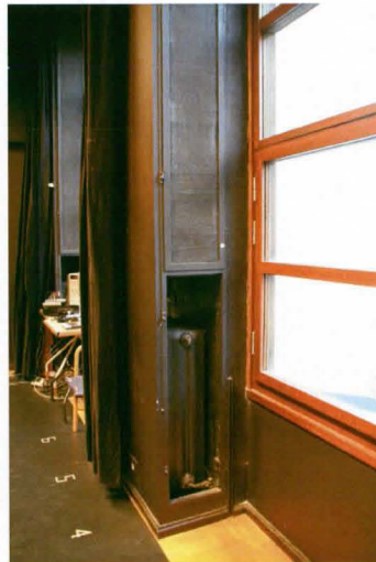
Ikkunoiden välissä 1930-luvun rakenne lämmitystä ja ilmanvaihtoa varten. Tekniikka on kätkeyty perforoitujen ovien taakse.
