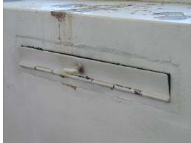
Kasarmin tuuletusventtiili. MV. Tirilä.
