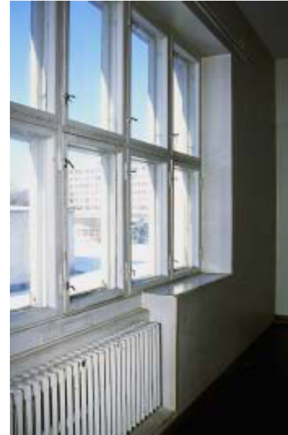
Valon saanti, tuuletus ja lämmitys yhdistyvät ikkunaseinässä. MV. Tirilä.
