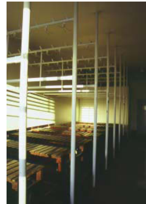
1930-luvun hygienia-ajattelua toteutettuna vaatteiden kuivaushuoneissa. Kuvassa teräsputkesta tehty kuivaustelineet ja niiden alla puiset kuivauspenkit. MV. Tirilä.
