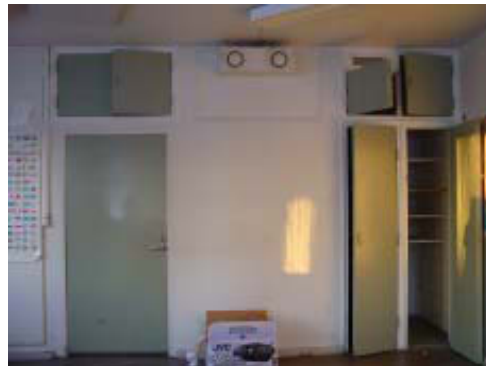
Uusitut IV-asennukset on sijoitettu komeroseinään. MV. Jetsonen.
