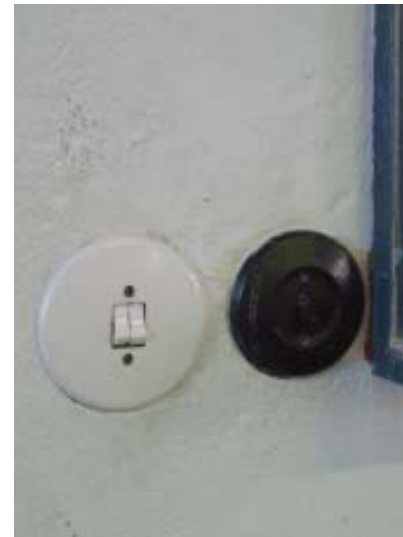
Uusi ja vanha sähköasennus vierekkäin opetustiloissa. MV. Jetsonen.
