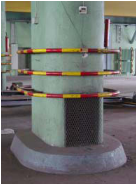
Autohallin pilariin kytketty IV-hormi törmäyssuojineen. MV. Jetsonen.
