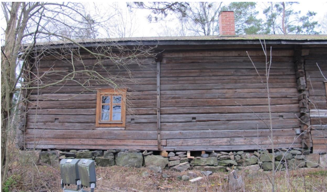
Kuva 8. Pirtin pohjoisseinän keskikohdalla on selkeästi nähtävissä painuma.
