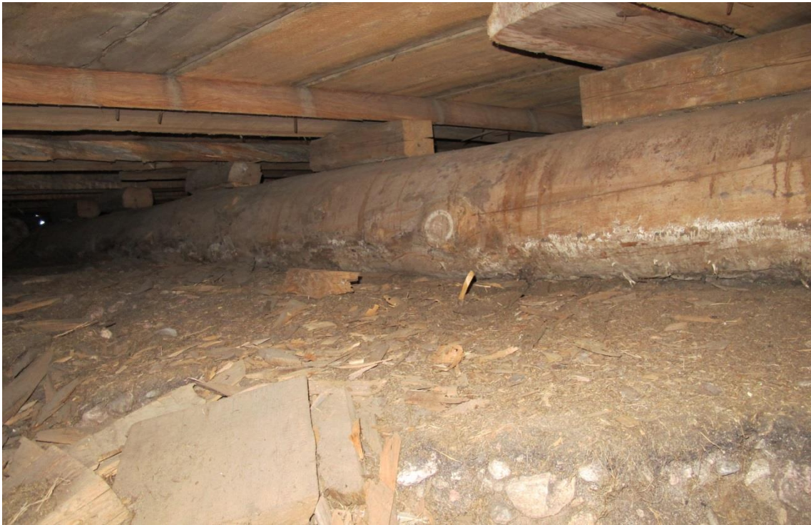
Kuva 3. Alapohjassa oli paikoitellen runsaasti puujätettä.
